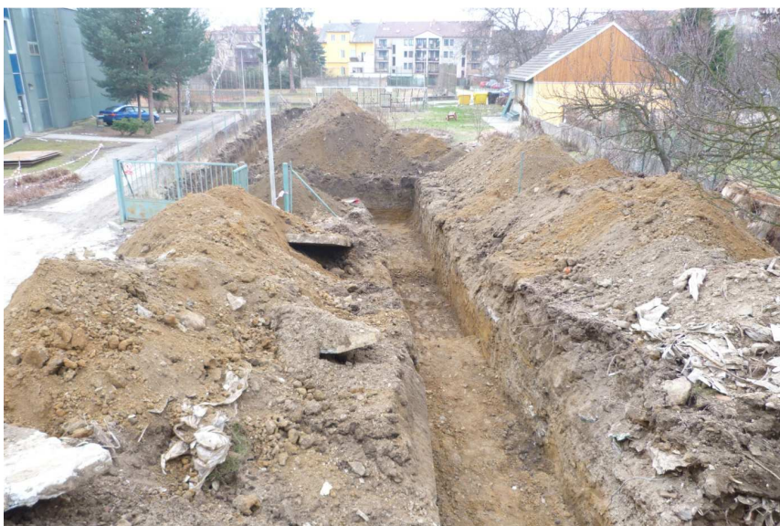
A pak přišla pohroma – oprava centrálního teplovodu. Přes všechny domluvy o postupu prací byl výsledek devastující. Zmizela zídka, záhony i bylinná spirála. Na zahradu byl vstup zakázán.
